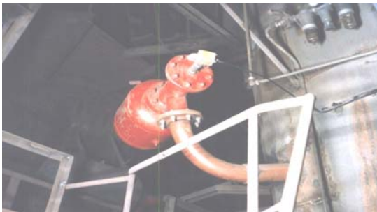
IRON ORE Metallic Bunker ISPAT-SIDEX SA GALATI - ROMANIA
