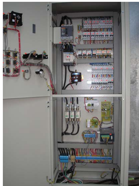
Fig.7. Vedere în interior-dulap acționare DAE-LIUE
