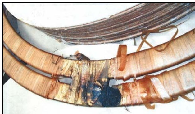
Fig.7 Fotografia ecranului defect.
